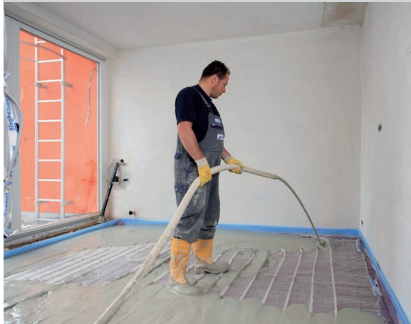
Energieoptimierung beim Knauf-Objekt in München
